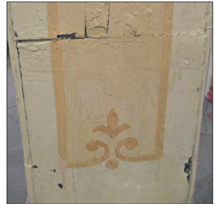
Das Holz an den Stützpfelern der Schlosskirche ist gerissen. Foto: a.ber
